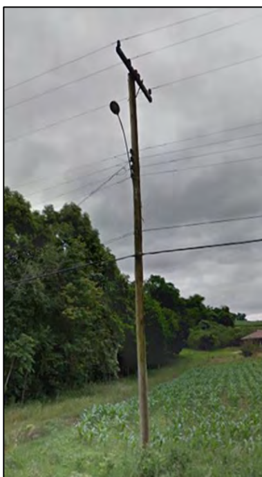
Figura 13 - Iluminação - Sistema 7 - VM 125W - Rua Felipe Eckert
