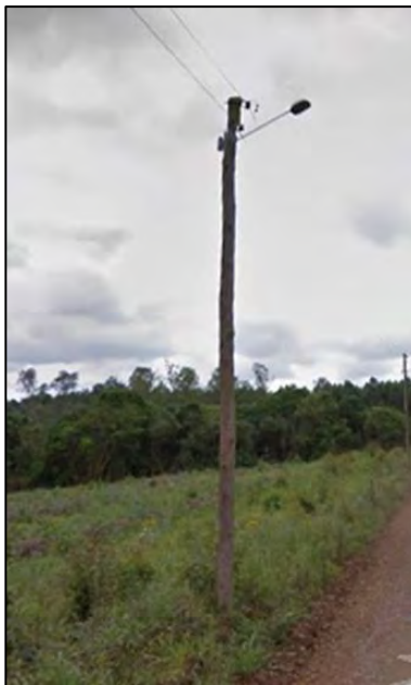
Figura 12 - Iluminação - Sistema 6 - VM 400W - Rua Dom Pedro II
