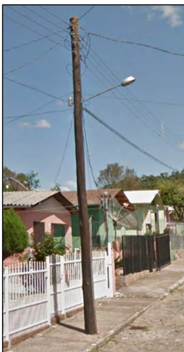
Figura 11 - Iluminação - Sistema 5 - VSAP 70W - Rua Oscar de Castro
