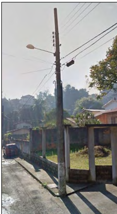
Figura 7 - Iluminação - Sistema 1 - VSAP 250W - Rua Bento Gonçalves
